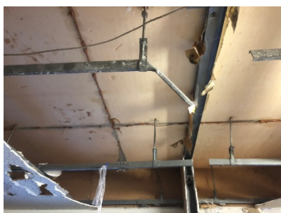
C 棟 5 階天井部分の損壊
