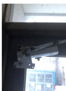
玄関ドアの破損
