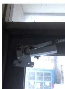
玄関ドアの破損
