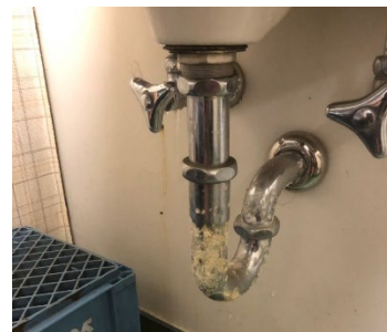
A 棟 2 階洗面台の水漏れ
