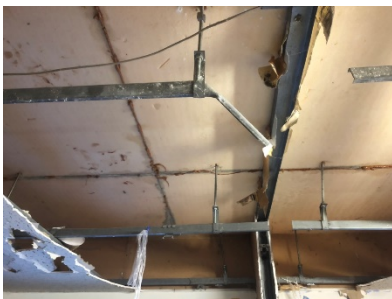
C 棟 5 階天井部分の損壊
