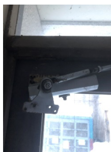
玄関ドアの破損
