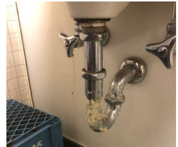
A 棟 2 階洗面台の水漏れ
