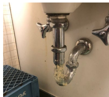
A 棟 2 階洗面台の水漏れ
