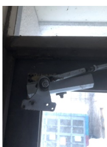
玄関ドアの破損
