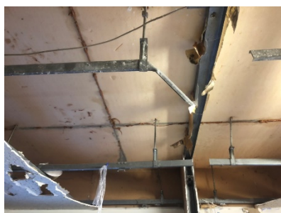
C 棟 5 階天井部分の損壊
