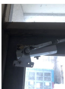
玄関ドアの破損
