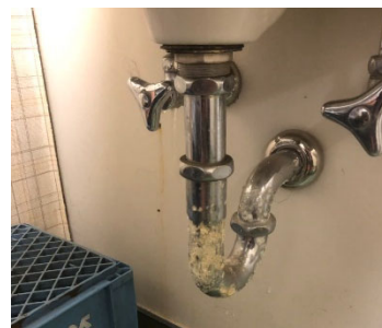
A 棟 2 階洗面台の水漏れ
