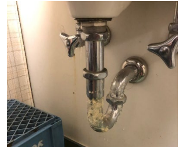
A 棟 2 階洗面台の水漏れ
