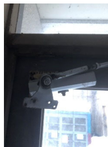
玄関ドアの破損
