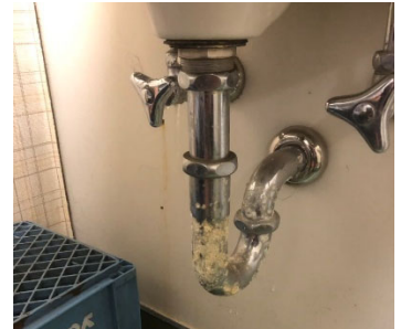
A 棟 2 階洗面台の水漏れ
