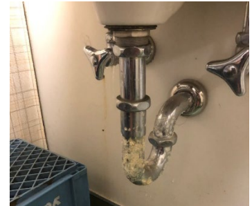
A 棟 2 階洗面台の水漏れ
