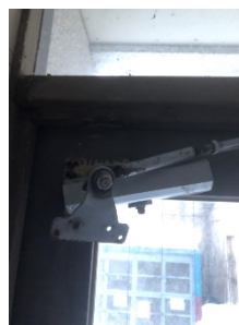
玄関ドアの破損
