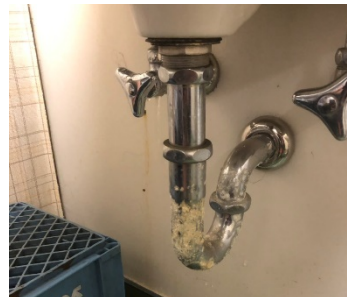
A 棟 2 階洗面台の水漏れ
