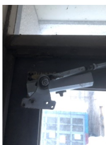
玄関ドアの破損
