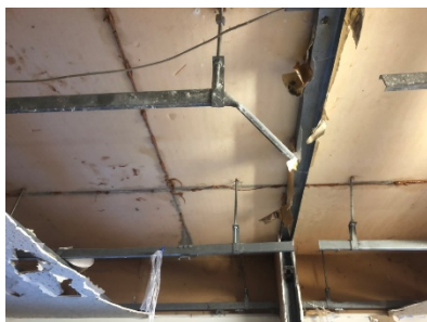
C 棟 5 階天井部分の損壊
