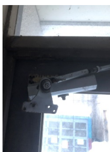
玄関ドアの破損
