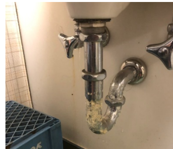
A 棟 2 階洗面台の水漏れ
