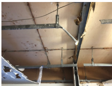
C 棟 5 階天井部分の損壊
