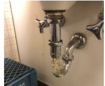
A 棟 2 階洗面台の水漏れ
