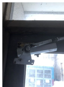
玄関ドアの破損
