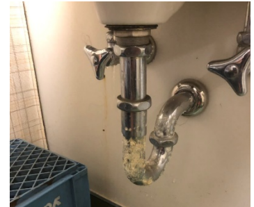
A 棟 2 階洗面台の水漏れ
