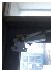
玄関ドアの破損
