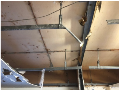
C 棟 5 階天井部分の損壊
