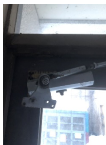
玄関ドアの破損
