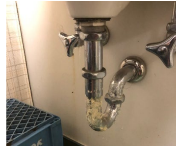
A 棟 2 階洗面台の水漏れ
