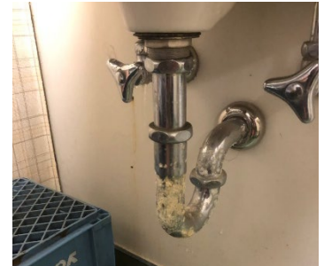
A 棟 2 階洗面台の水漏れ
