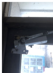
玄関ドアの破損
