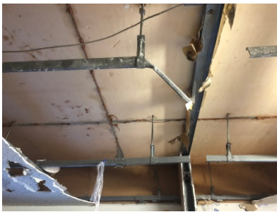
C 棟 5 階天井部分の損壊
