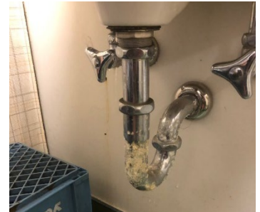
A 棟 2 階洗面台の水漏れ
